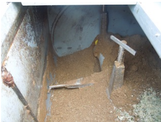
ゴミサー槽内/右下に脱水された生ゴミ有り。
