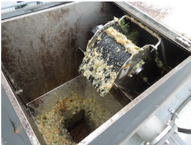
脱水機から槽内へ
